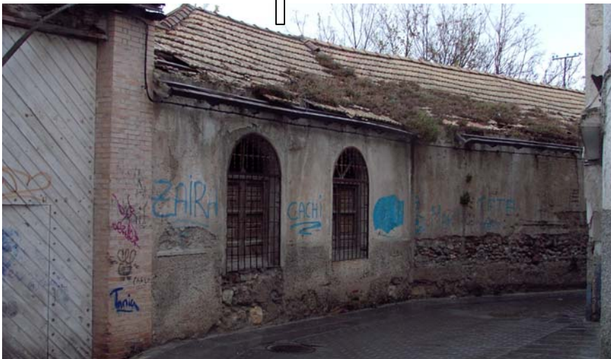
Hundimiento de cubiertas y aleros. Calle Tabernica.
